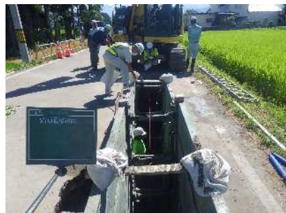
管路布設状況 確認 立山特環汚水枝線 管渠 工事 発注者：中新川広域行政事務組合 〔施工管理〕
