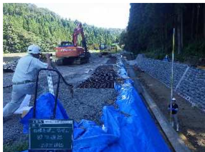
護岸基礎工基準高 確認 片貝川水系尾山大谷川 護岸工 工事 発注者：富山県新川土木センター入善土木事務所 〔施工管理〕
