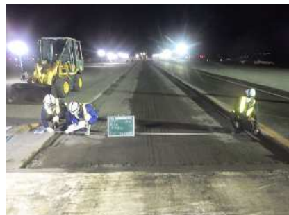
路面切削状況 確認 富山空港 滑走路舗装 工事 発注者：富山県総合交通政策室 〔設計積算・施工管理〕
